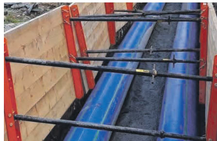
Bild: Fernwärmeleitung, Programm "erneuerbar"
