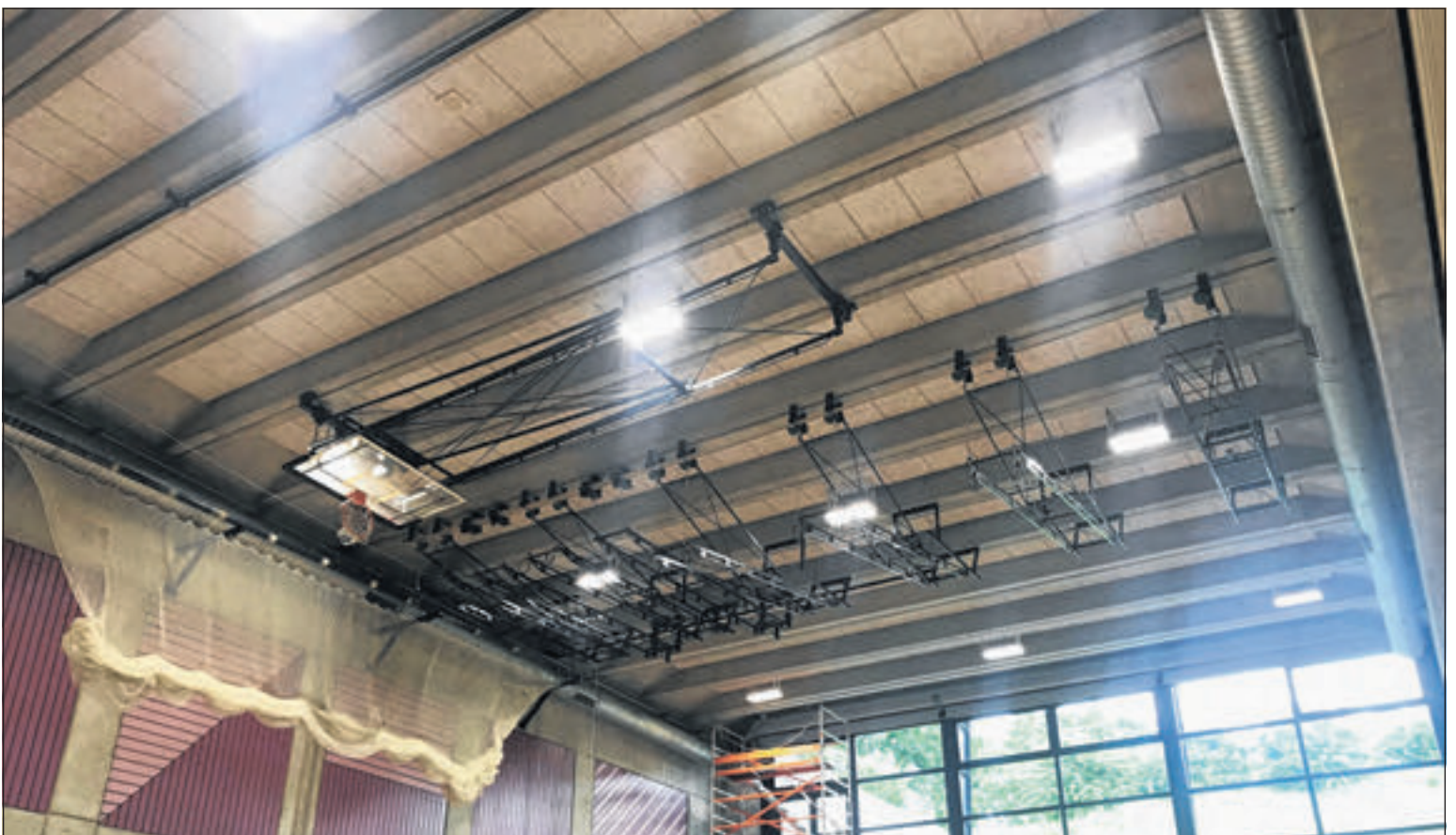
Neue LED-Leuchten erhellen die Sporthalle.
