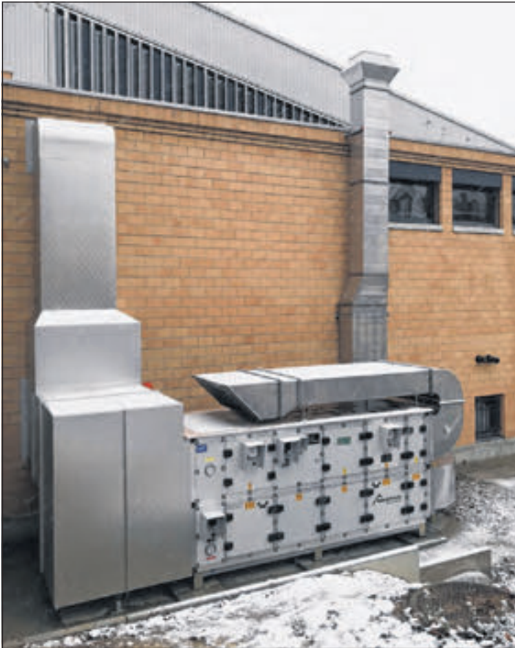
Neue Lüftungen aussen mit Wärmerückgewinnung.
