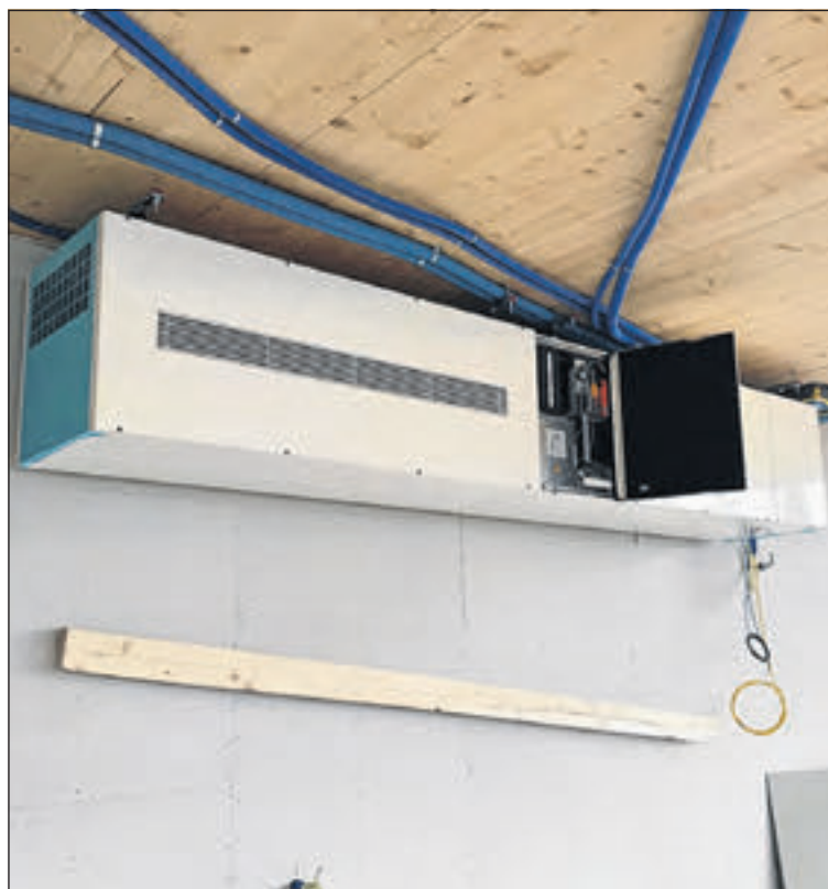
Die neuen Schulzimmer im obersten Stockwerk erhalten wie geplant ein eigenes dezentrales Lüftungsmodul, welches die Luftqualität für den Unterricht sicherstellt. Die Fenster können trotzdem geöffnet werden.
