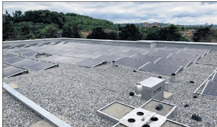
Auf kantonseigenen Gebäuden hat der Kanton Baselland Fotovoltaikanlagen installiert. Im Bild: die Sekundarschule Hinterzweien. Foto zVg
