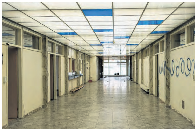
Die leeren Gänge der alten Gemeindeverwaltung wirken wüst, doch werden sie vor der Demolierung noch genutzt. Fotos David Renner
