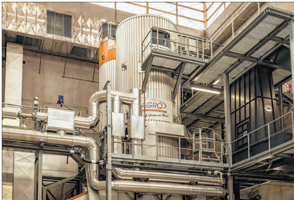
Im Heizkessel werden je zur Hälfte Altholz und Waldhack verbrannt. Über einen Wärmetauscher wird Wasser erwärmt und in einem Kreislaufsystem zu den Abnehmerinnen und Abnehmern transportiert. Fotos David Renner
