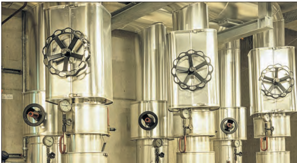
Im Untergeschoss der Wärmezentrale liegen die Rohre nach und von Pratteln. Das Wasser wird mit 90 Grad Celsius weggepumpt und kommt mir rund 60 °C zurück.
