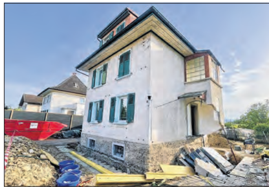
Die Gefahr von weiteren herabfallenden Teilen erschwerte die Bergung eines Verletzten.
