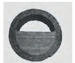
Verkalkte Wasserleitung nach 10 Jahren ohne Reinigung.
