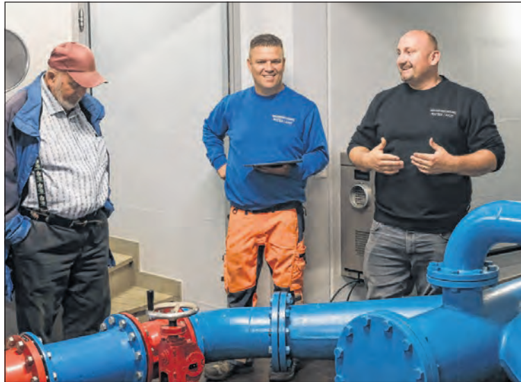
Im Untergeschoss des Pumperwerks Remeli erklärte Mario Matkovic (rechts) Details zur Wasserversorgung der Gemeinde. Fotos David Renner
