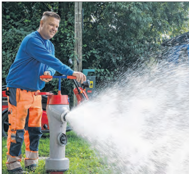
Als Adis Velic von der Wasserversorgung einen der 433 Prattler Hydranten öffnete, schossen enorme Wassermassen heraus.
